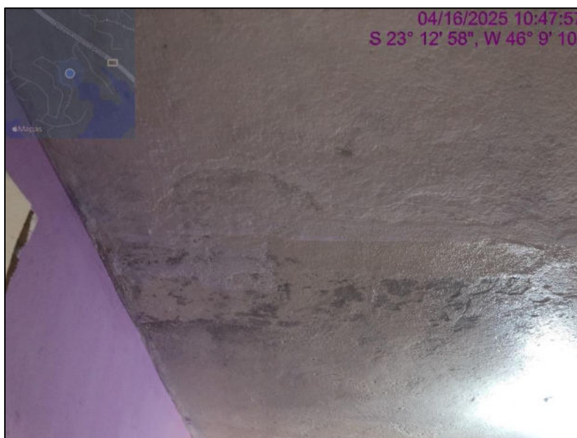
FOTO 61: Detalhe do teto do dormitório 1 da casa do caseiro da unidade avalianda.
