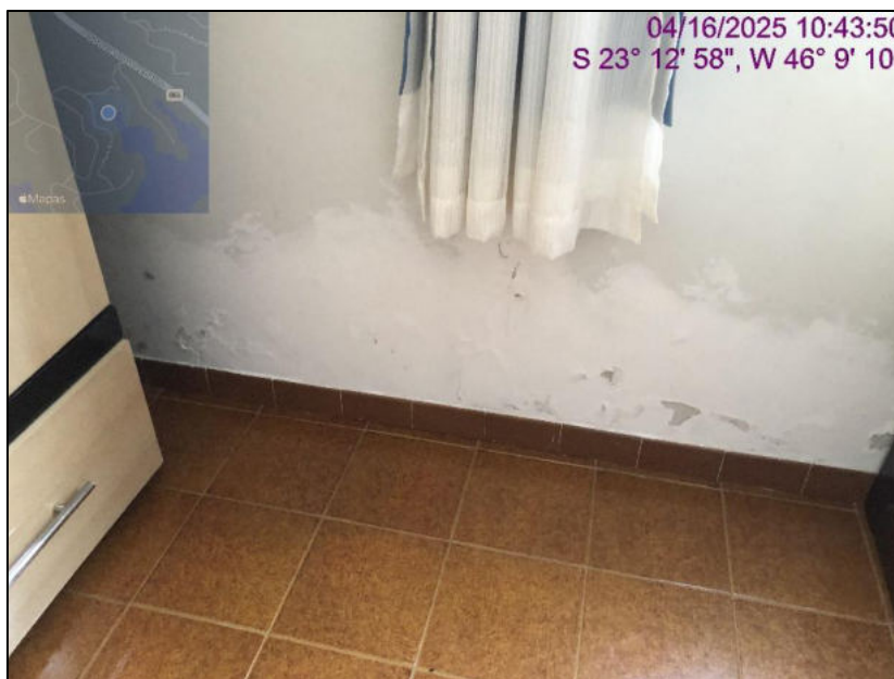
FOTO 39: Detalhe da parede dormitório 4 da casa principal da unidade avalianda.
